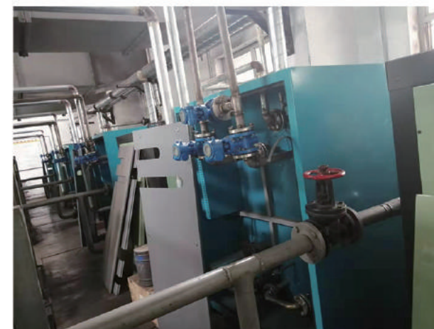
▲ 晋煤集团赵庄煤业2号机房
