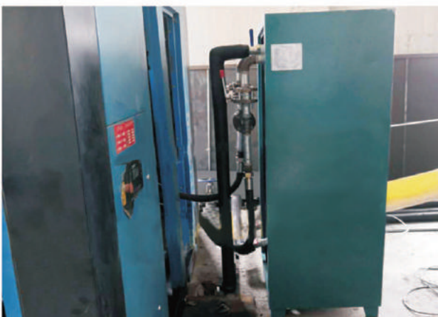
▲ 新疆同泰煤业有限公司 2台185KW空压机余热回收 满足200人洗澡
